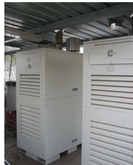
Figura 3. Microturbinas instaladas en el vertedero de Oris
